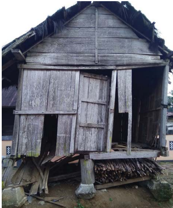
Rumah Adat Lebong yang Rusak
